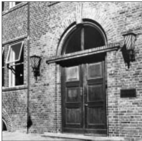
Dieser alte Eingang in der Schwentinestraße wurde zugemauert, als der Haupteingang von der Grenzstraße geschaffen wurde. Die Mitarbeiter sollten später den Eingang Luisenstraße beim Pförtner benutzen.
